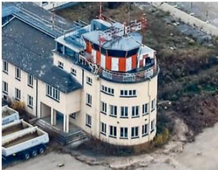
Der Tower vor der Sanierung: Die Kuppel war aus energetischen Gründen nicht mehr brauchbar. ARCHIVFOTO: HÄSLER
